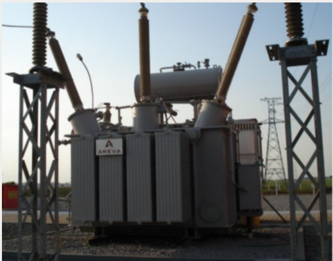
Рисунок 2: Трехфазный шунтирующий реактор напряжением 22 МВА 245 кВ установленный на подстанции Вилена, Бразилия
